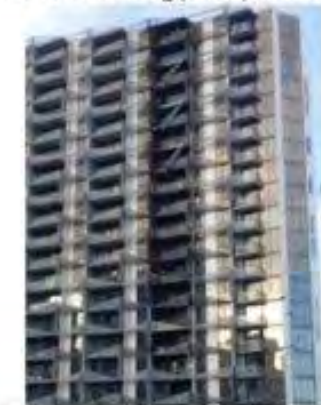
(d) The Lacrosse Building (Melbourne) after the fire
